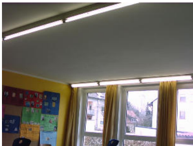
Abbildung 38: Beleuchtungsanlage der Klassenzimmer vor der Umrüstung
