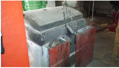
Abbildung 43: Holzackschnitzelheizung der Gemeinde Oberhaid
