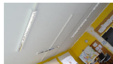
Abbildung 41: Beleuchtungsanlage der Klassenzimmer nach der Umrüstung
