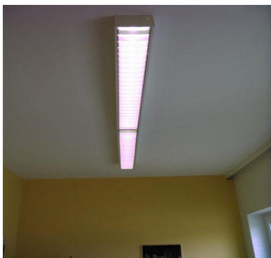
Abbildung 39: Beleuchtungsanlage der Klassenzimmer vor der Umrüstung
